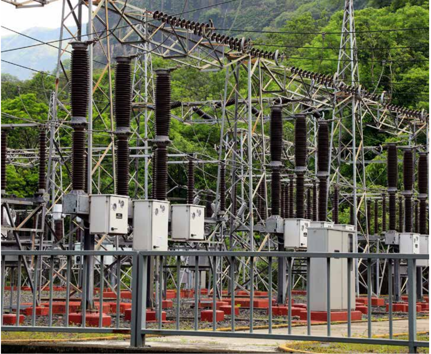
Planta de energía, hidroeléctrica Jurún Marinalá. MEM
